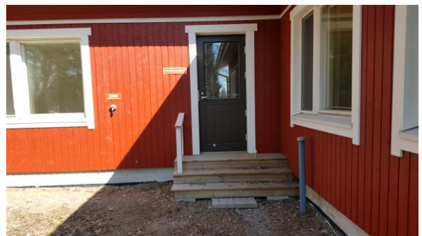
6. Ulko-ovet ovat hyväkuntoisia. Terassin ovi on vaihdettu.
