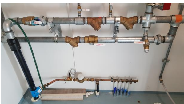
13. Rakennuksessa on jälkiasennettu sprinkler -laitteisto. Laitehuoneen lattiassa ei ole vesieristystä.
