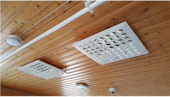
17. Ilmanvaihdon jakajia olohuoneen katossa.
