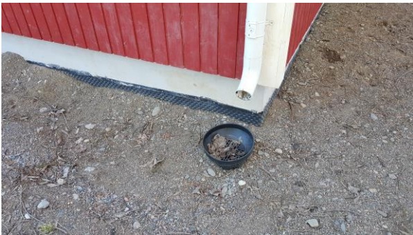
1. Rakennuksen ympärille on sadevesijärjestelmä. Syöksytörvien päitä tulisi kuitenkin muuttaa, että vedet johtuisivat luotettavasti loiskekaivoon.
