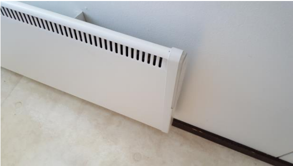
19. Huoneissa on sähköpatterit.
