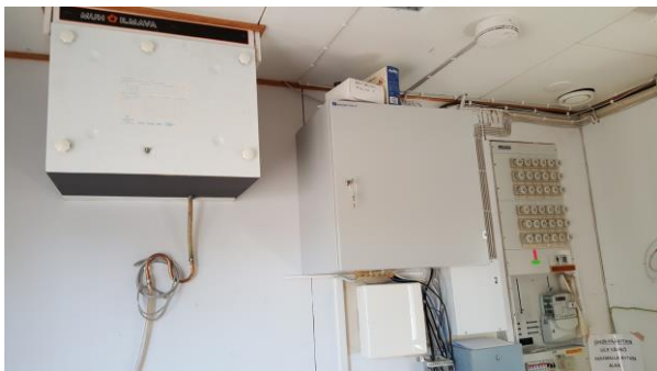
15. Teknisiä laitteita Järviharjuntien puoleisessa päädyssä.
