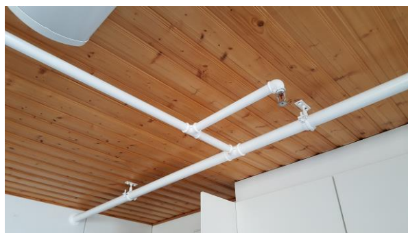
14. Sprinkler -putkia olohuoneen katossa.
