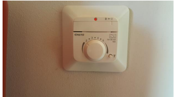
20. Märkätiloissa on lattialämmityksiä.
