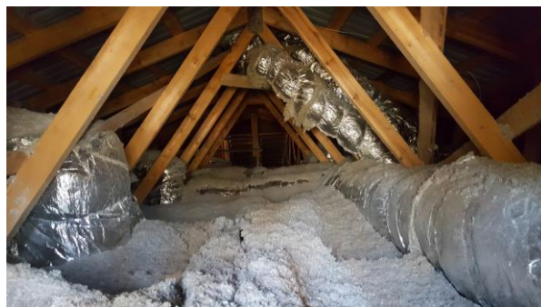
12. Yläpohjan eristetilaan tulisi asentaa käyntisilta.
